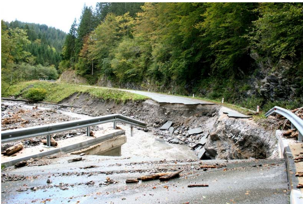
Slika 25. Močna bočna erozija Zadnje Sore je močno preoblikovala strugo in odnesla nekaj metrov ceste. Foto: Jaka Ortar
