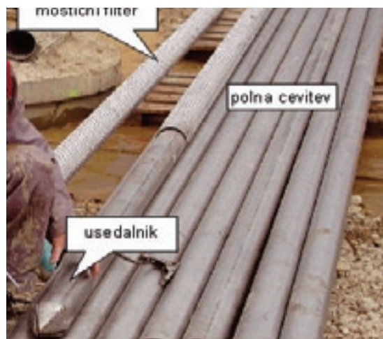
Slika 7: Cevitev vrtine hidrološke postaje za podzemne vode.
