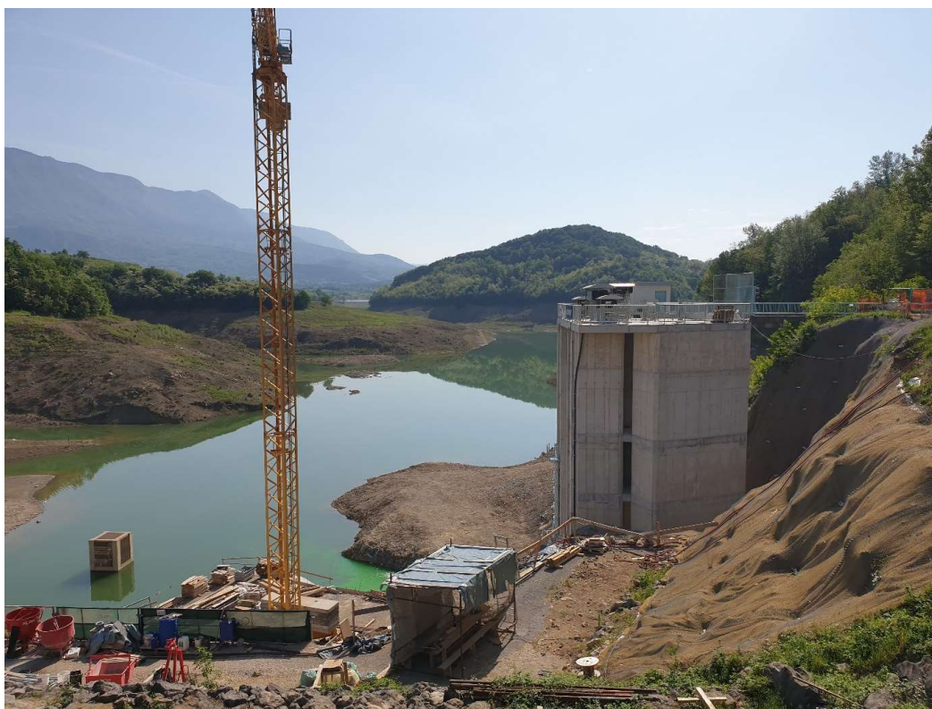
Slika 1. Obnova pregrade vodnega zadrževalnika Vogršček, ki je bil pred tridesetimi leti zgrajen za namakanje polj in nasadov v Vipavski dolini (foto: M. Andjelov)
